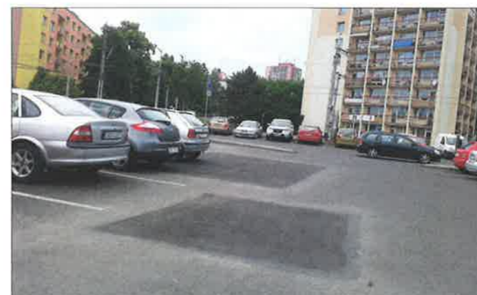
Opravené propady na parkovišti v Neštěmících u nákupního střediska
